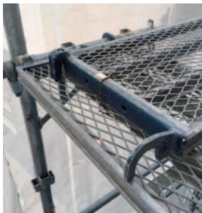
図2-16 不安定な作業床を番線で固定
