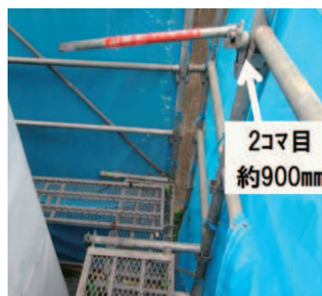
図2-18 段差のある作業床の端部にストッパーを取付けた例 (ストッパーは高い方に設置)
